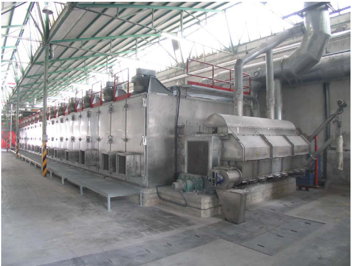
Secadero de Banda INGETECSA de 3,2x28 metros útiles, equipado con Banda de Levas
